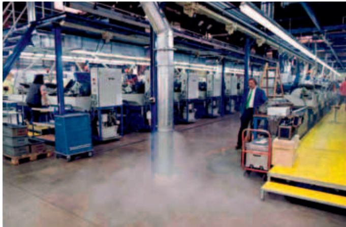
Abbildung 9: Schichtlüftung im praktischen Einsatz.
