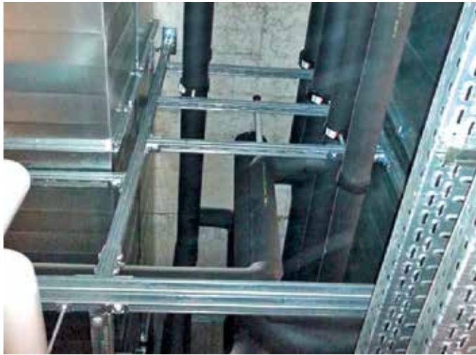
Abbildung 2: Überbauung von Kabeltragsystemen mit Funktionserhalt durch Rohrleitungen Foto: Hilti Deutschland AG
