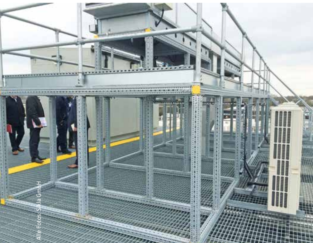
Abbildung 1: Unterkonstruktion für Aggregate
