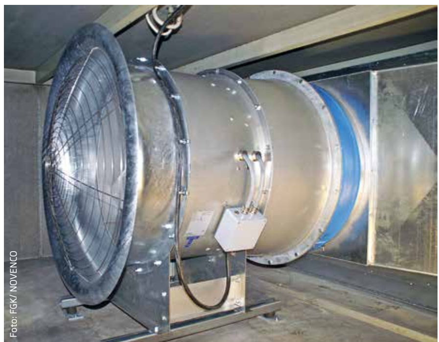
Abbildung 7: Axialventilator nach der Modernisierung
