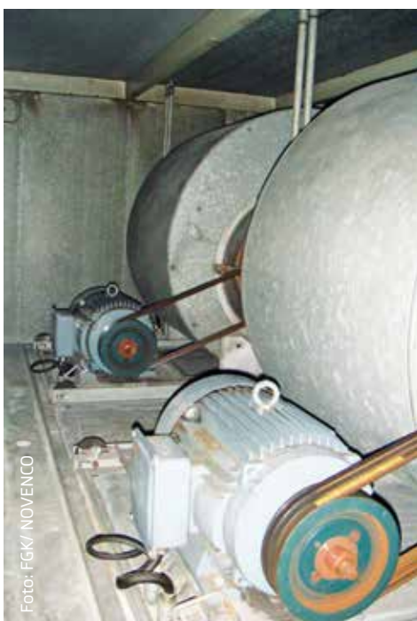
Abbildung 6: Radialventilator vor der Modernisierung
